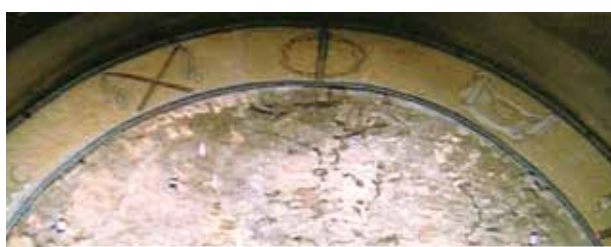
Sklepienie poplamione Krwcią
